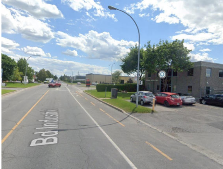
Figure 4-11 : Absence de trottoir en bordure de l'arrêt d'autobus à l'intersection des boulevards Industriel et Franquet
